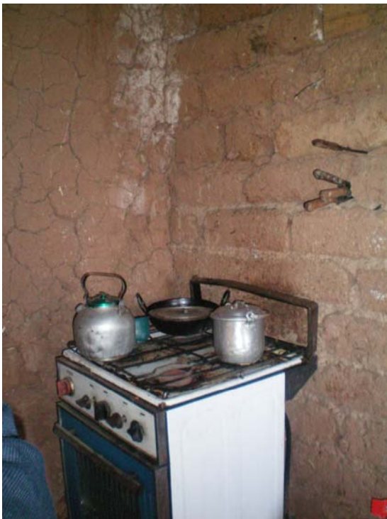
Ilustración 15. Algunas familias que han tenido más dificultad o se han sumado en la segunda fase al proyecto, aún no han revocado las paredes de sus cocinas. Barriada de Israel.
