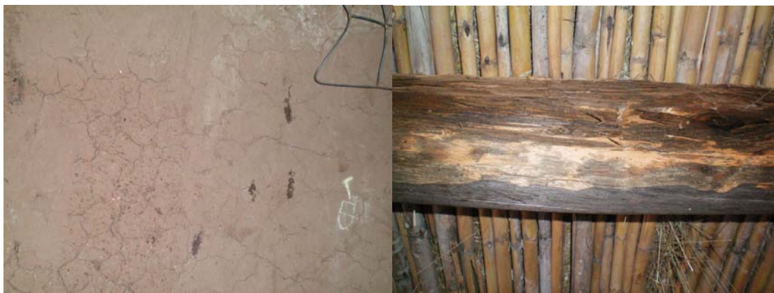
Ilustraciones 4 y 5. La vinchuca anida en las grietas de las paredes de adobe. Parte del proyecto de salubridad de MM ha consistido en revocar las paredes y techos. Barriada de Israel.
